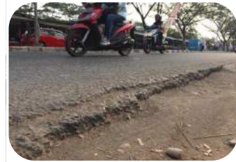
写真2 切削オーバーレイ工法の必要な車道 ※切削オーバーレイ工法：路面切削後に放送の施工を行う工法
