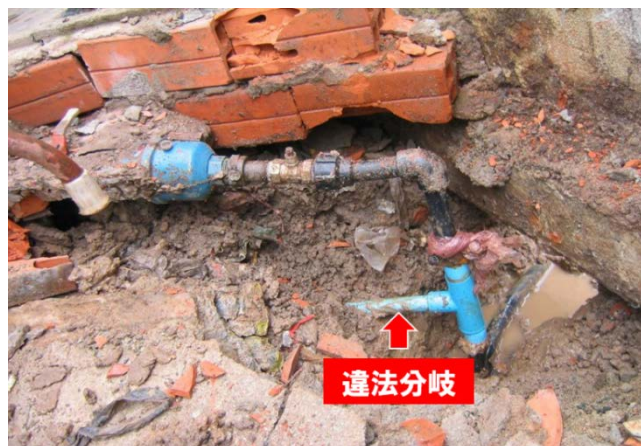
図 3.1.7 漏水・盗水調査で発見された違法分岐 素人工事による違法分岐が、盗水に加えて、新たな漏水原因となっていた。
